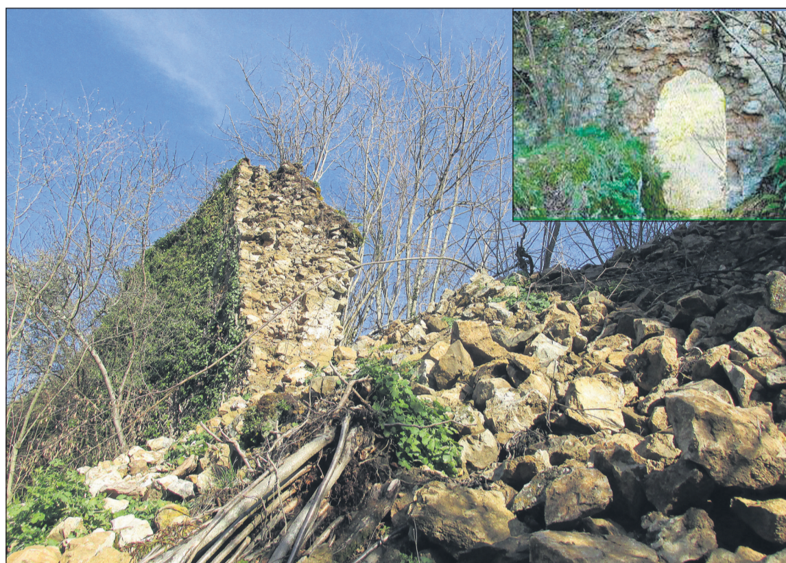
En la imagen, el muro y la puerta de arco de medio punto convertidos en piedras tras el derrumbe. En el recuadro de arriba, antes de arruinarse.
