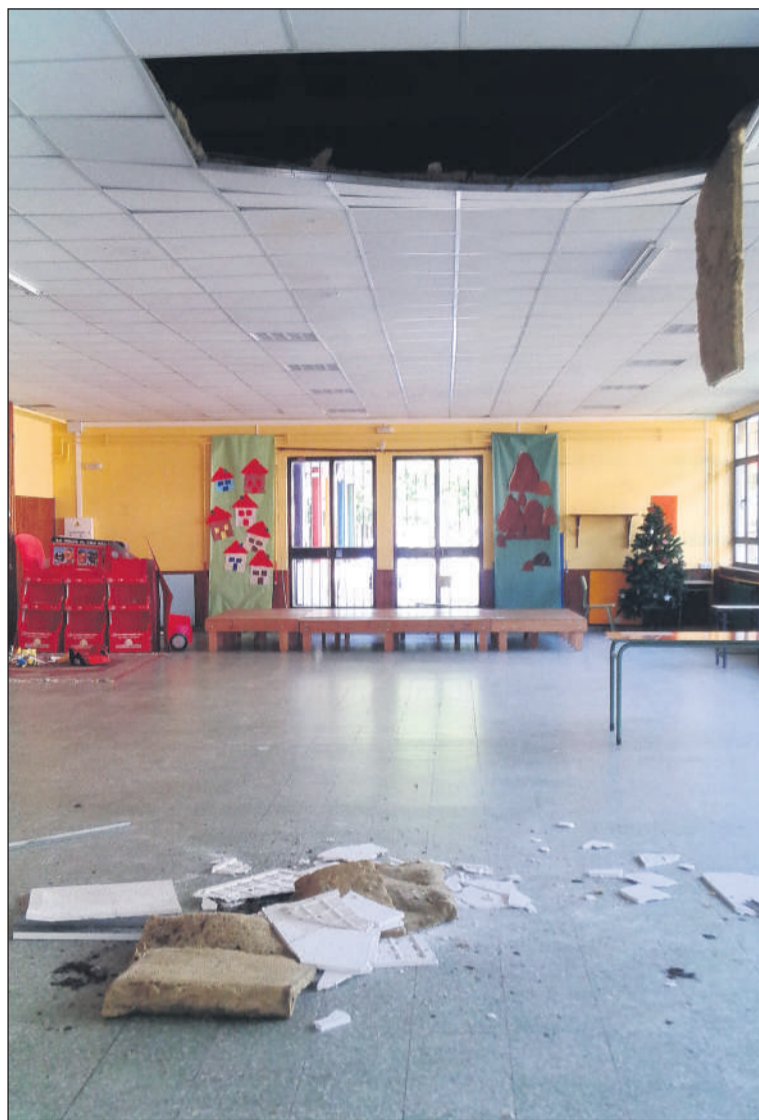
El techo desprendido del comedor / Foto de J. C.
