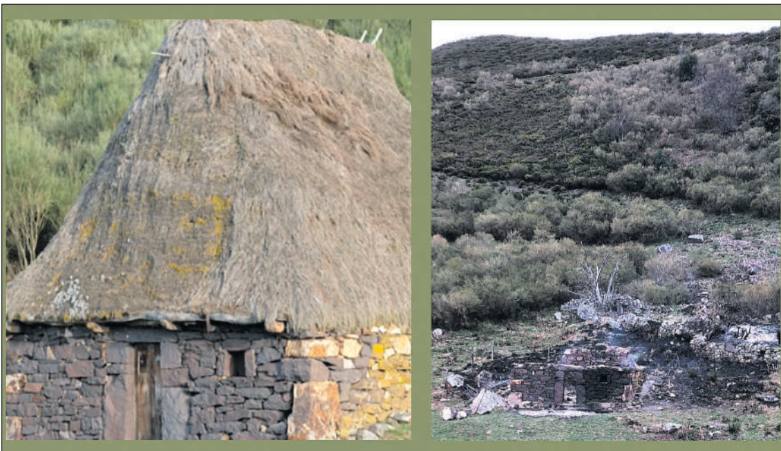
El techo de la braña de Cuérrago, arrasado
